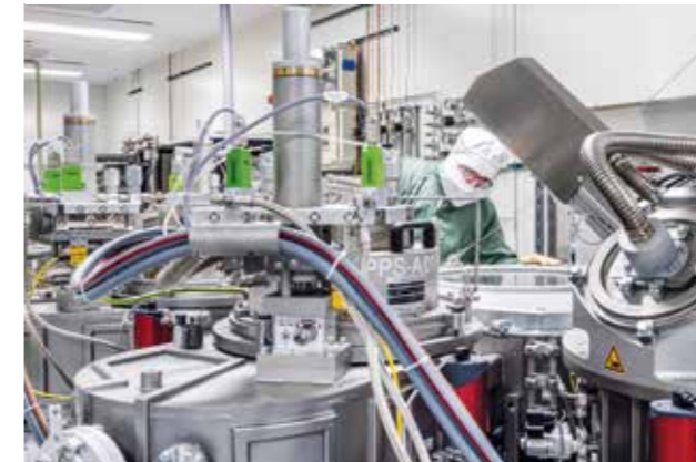
Techniker überprüft und wartet die Infrastruktur des Reinraums.
